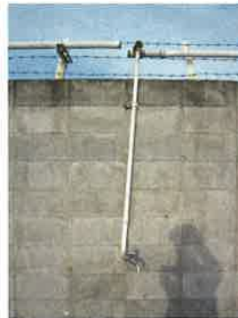
パイプのずれ
