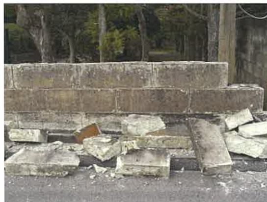
⑥ 校舎周辺 3号館前の道路。 校舎周辺では、大谷石 の外壁が崩れている光景 をよく目にした。
