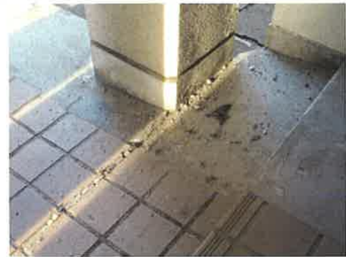
渡り廊下・目地の割れ
