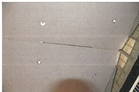
写真 15 天井の継ぎ目の一部が崩落
