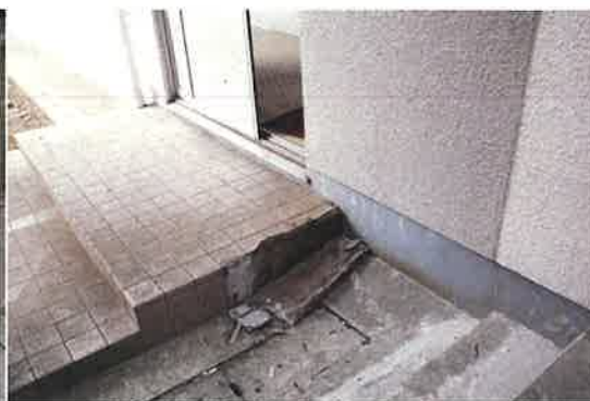
写真 18 タイルの一部が崩壊
