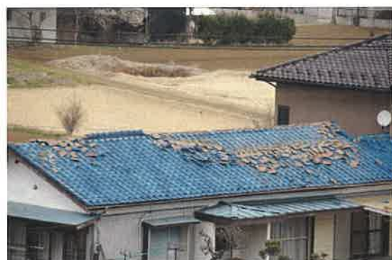
写真 19 学校周辺の家屋の被害状況 (その 1)
