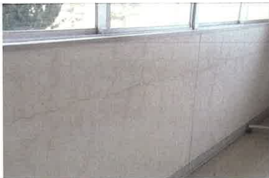
写真5 壁に生じたひび
