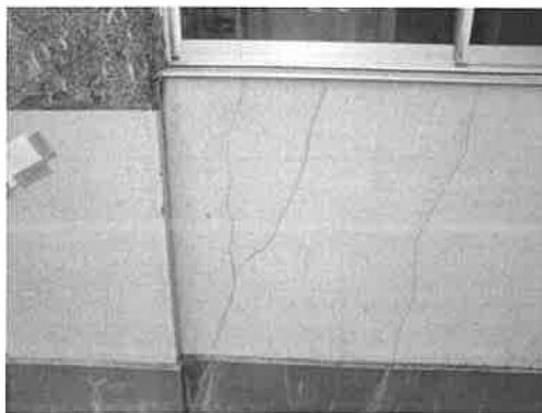
特別教室棟 1 階の外壁のひび
