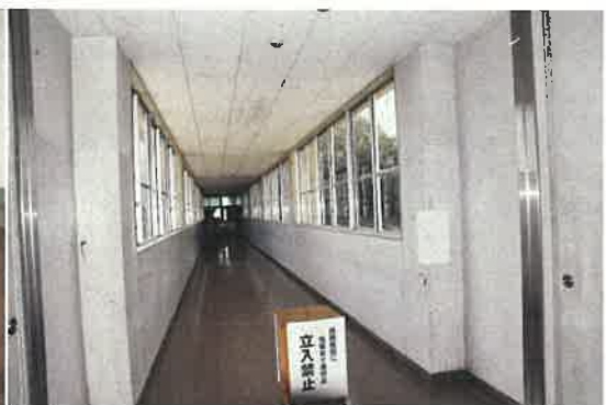
写真 14 本館から特別教室棟への 渡り廊下の立入禁止
