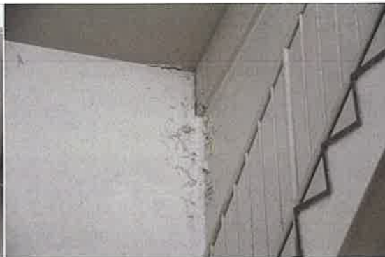
写真6 天井の一部が崩れる
